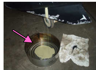
ギアボックス内に海水が混入すると、このようにオイルが白濁し、異常摩耗でギアの破損につながります。
